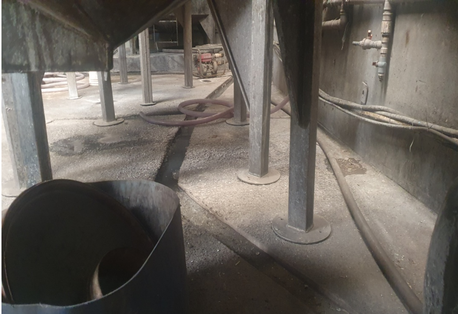
Foto 07: Canaletas ligando ao sistema de caixas.
