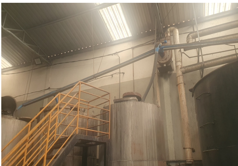
Foto 06: Misturadores com sistema de condensação de gás.
