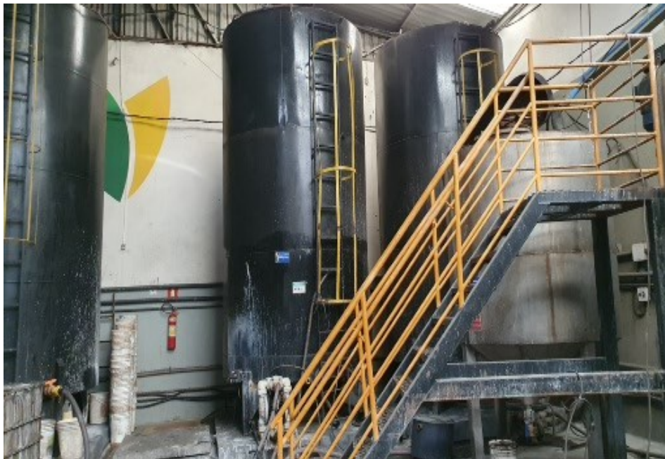
Foto 07: 3 Reservatórios cilíndricos na cor preta utilizado para armazenagem de água.
